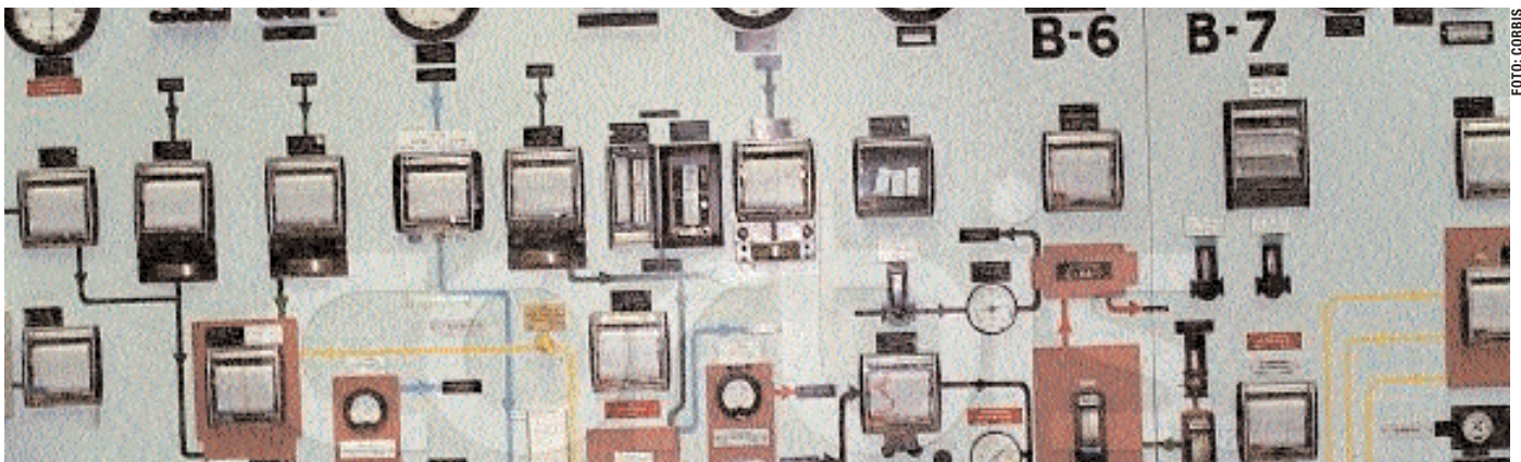
Man ska inte behöva vara teknikproffs för att sköta styrsystemen.
