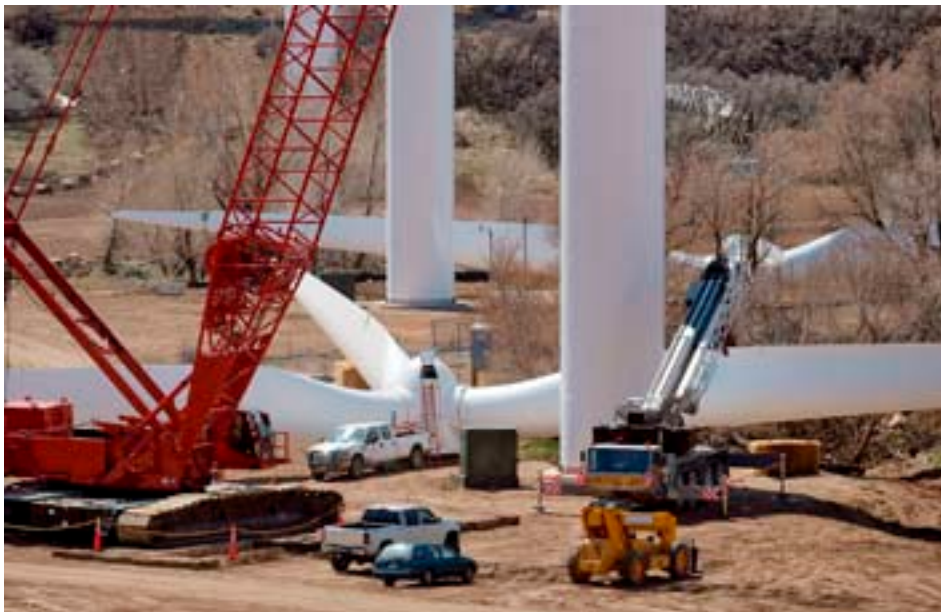
Kostnaden för att montera ned vindkraftverk kan bli stor, enligt en ny undersökning.
