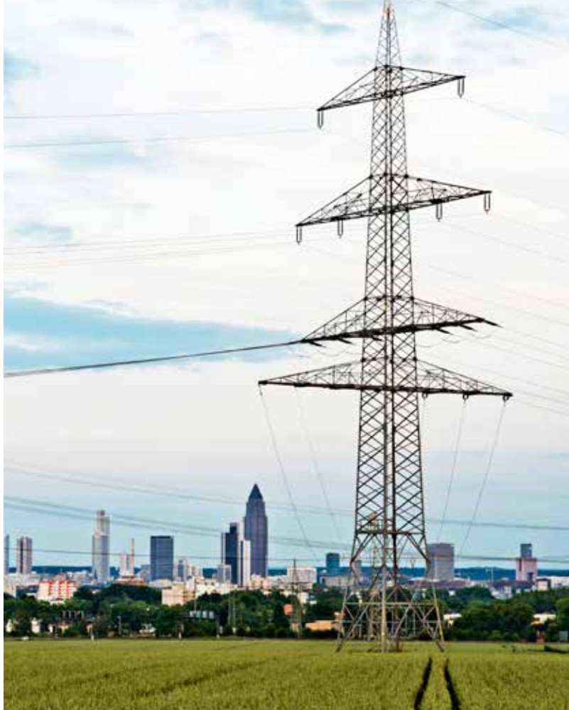
Elledning utanför Frankfurt.
