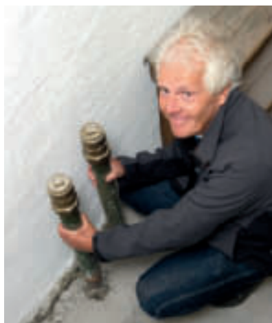
Willy Ociansson tror att ny energi kan användas i de gamla rören i garaget.
