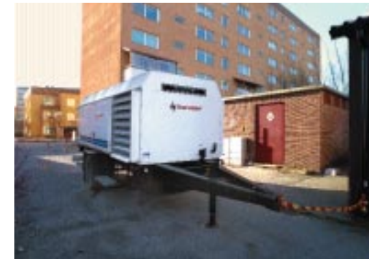
Mobilt diesel-drivet reservkraftaggregat på 100 kVA.
