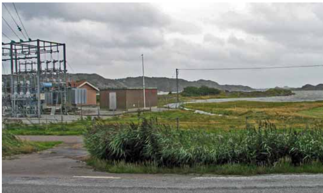
Figur 18. Exempel på nätstation som ligger nära havsytan. Bilden tagen den 31 juli 2009. Vinden var på denna plats västsydvästlig till västlig med medelvind på mellan 17 och 19 m/s och med byar upp till 26 m/s. Havsvattenståndet varierade mellan 46–62 cm över normalen under dagen. Foto: Energimyndigheten/Anna Fridén.
