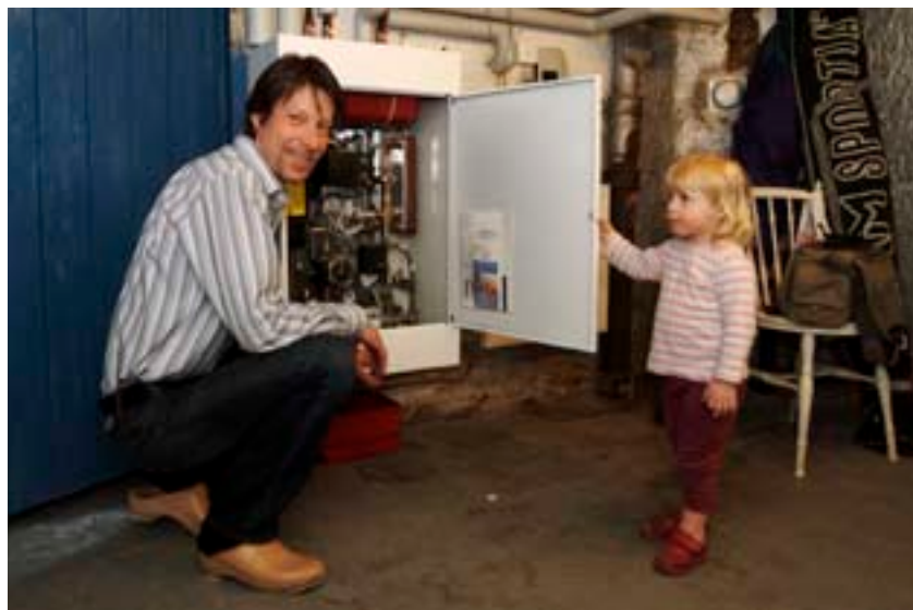
Mats Jansson och dottern Signe inspekterar den nya fjärrvärmearläggningen.
