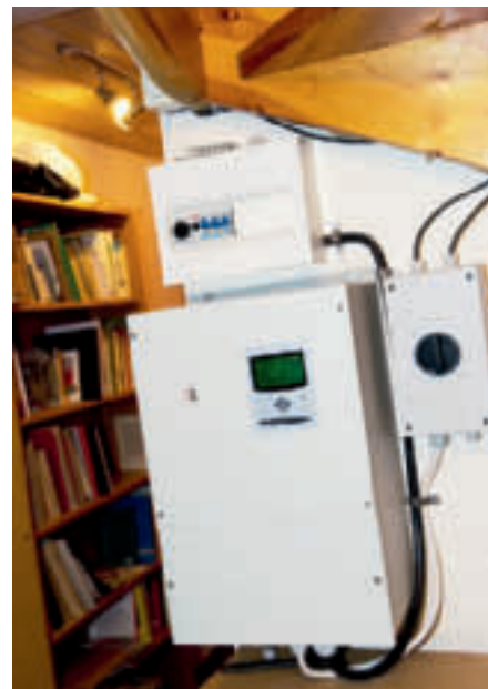
Avläsningsutrustning i familjens källare.
