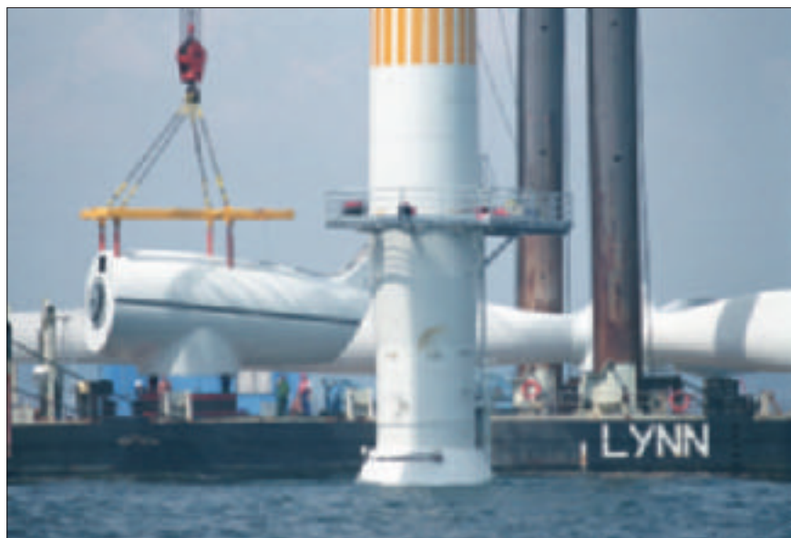
Lättare anläggningar minskar material- och hanteringskostnader. Maskinhuset till ett av Yttre Stengrunds 2-megawattsverk väger 85 ton. Foto: Gunnar Britse.
