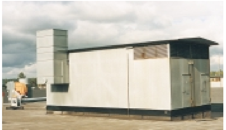
Ett av de stora tilluftsaggregaten för allmänventilation på taket på verkstadsbyggnaden.
