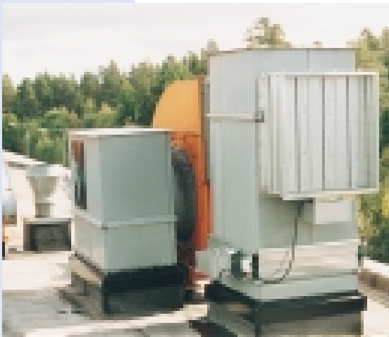
Utsugsfläkt med överkoppling till värmväxlare och tilluftsaggregat. Försett med ett spjäll som öppnas vid övertidsarbete så att stora tilluftsaggregatet inte behöver startas.
