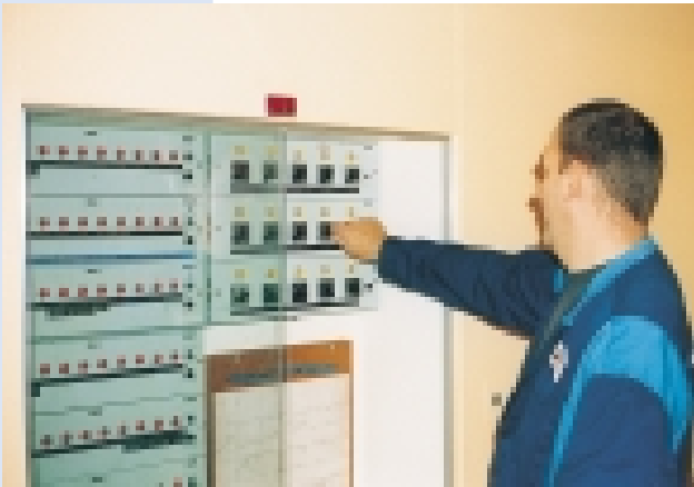
Manuell avstängning av allmänventilation. Låst skåp som inga andra har tillgång till.
