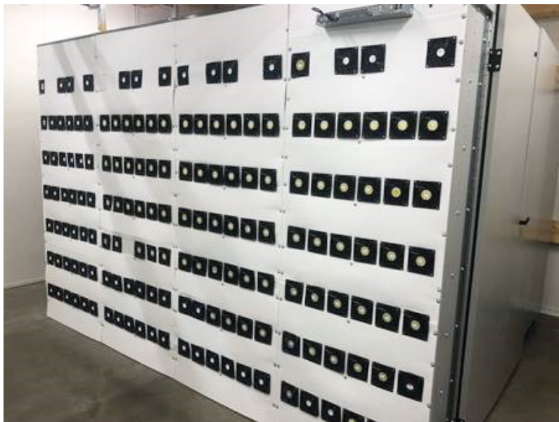
Figur 3. Datacenteranläggning för kryptovaluta med ASIC-rigg. Bild: RISE 25
