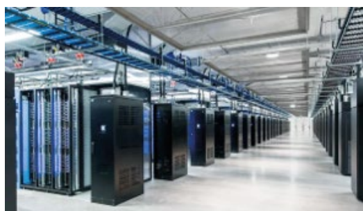
Figur 2. Insidan av ett datacenter. Bild: RISE 17
