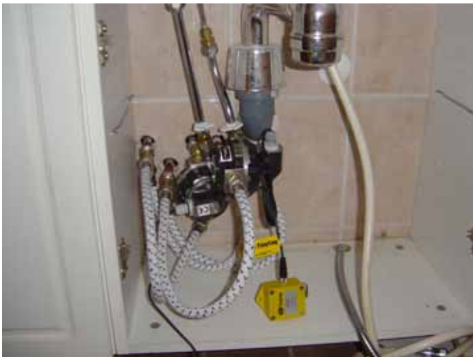
Figur 3. 2 Två Macnaught flödesmätare med logger monterade på kall- och varmvattenrör under ett tvättställ
