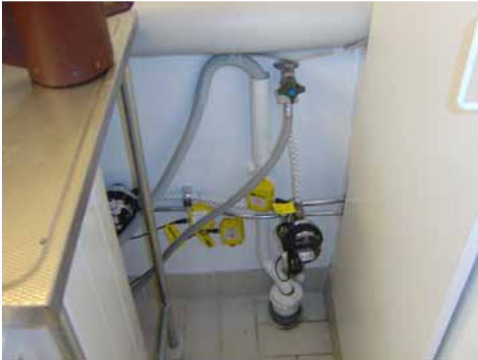
Figur 3. 4 Flödesmätare med logger monterade i grovkök
